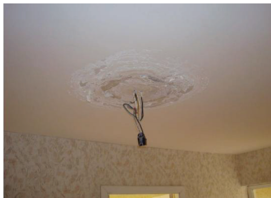
Перекрытия, 15 эт., следы протечек, повреждения отделочных слоев
