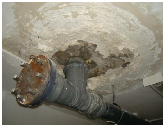
Перекрытия подвала, следы протечек, повреждения отделочных слоев
