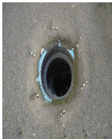
Рис. 5. Повреждение ливневой трубы
