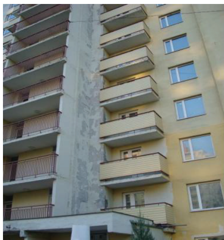
Рис. 4. Задний фасад, повреждения отделочных слоев
